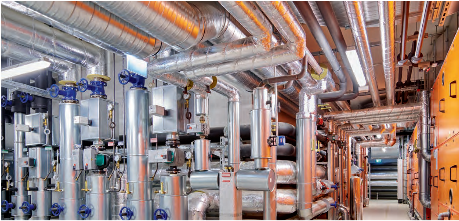
Blick in die Technikzentrale
