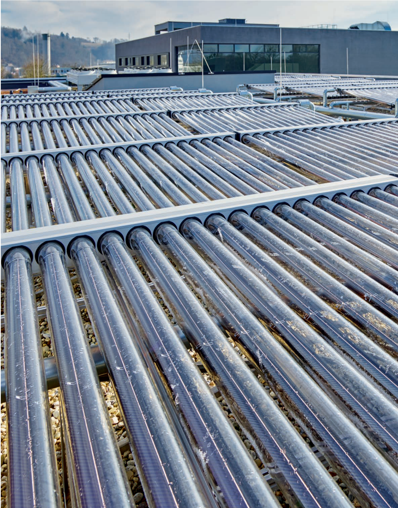
Technische Hochschule Deggendorf, Vakuum-Röhrenkollektoren
