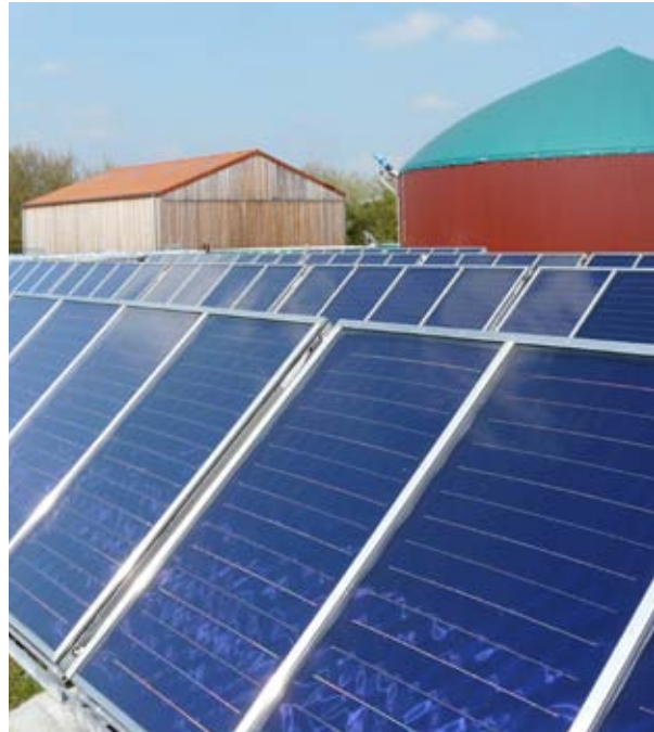
In der Modellstadt Wanzleben wurde der Versuch unternommen, die Wärmebereitstellung im Fernwärmesystem mit Solarthermie und einer Biogasanlage zu unterstützen. Quelle: Stadt Wanzleben
