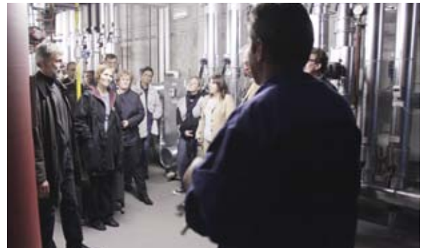
Das Pilotprojekt Warmwasserversorgung des IKMZ mit BHKW und Erdsonden wurde im Rahmen der 4. Erfahrungswerkstatt in Cottbus 2010 besucht.
