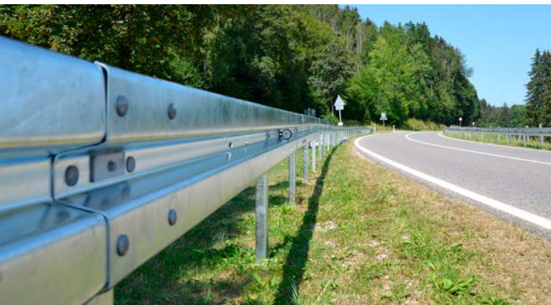
Fahrzeug-Rückhaltesysteme zum Schutz vor Aufprall auf gefährliche Hindernisse
