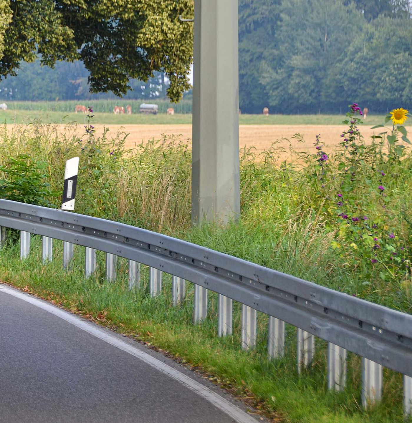
Fahrzeug-Rückhaltesystem vor festen Hindernissen (sicherer Seitenraum)
