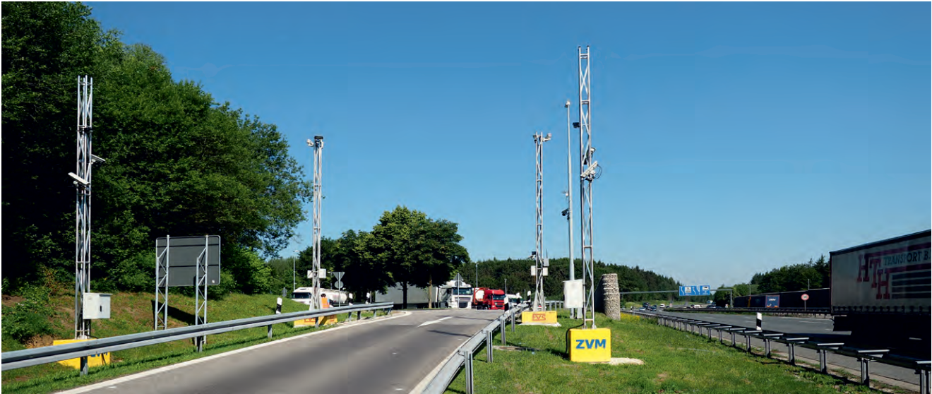
Sensorik im Ausfahrtbereich Testfeld Gelbsee
