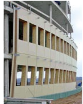
Abb. 02_02: Fassade des Bürogebäudes Energon in Ulm (Projektsteckbrief: siehe Kapitel 9) während der Bauphase: die komplett vorgefertigten Holz-Fassadenelemente in Passivhaus-Standard werden an die Geschossplatten gehängt. Pro Geschoss gibt es einen Elementtyp. [Quelle: Architekt Stefan Oehler]
