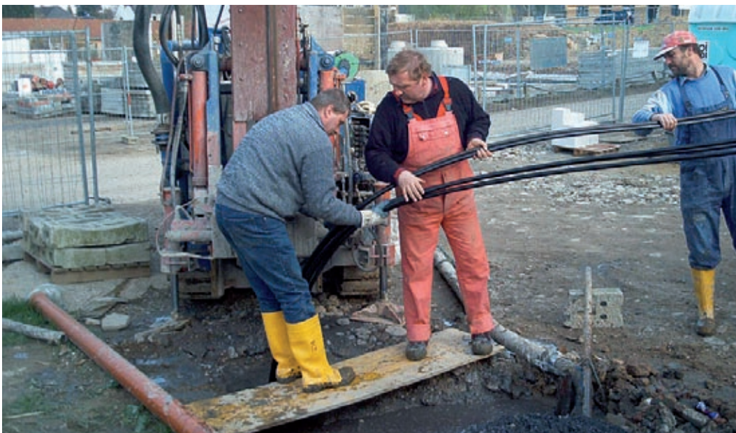
Abb. 06_01: Einbringen einer Erdsonde in das Bohrloch beim Neubau des Bürogebäudes BOB in Aachen. Die Erdsonden reichen bis in eine Tiefe von 45 m und sorgen in Verbindung mit einer Wärmepumpe und einer Betonkernaktivierung in den Geschosdecken für die Wärme- und Kältebereitstellung. [Quelle: VIKA Ingenieure]
