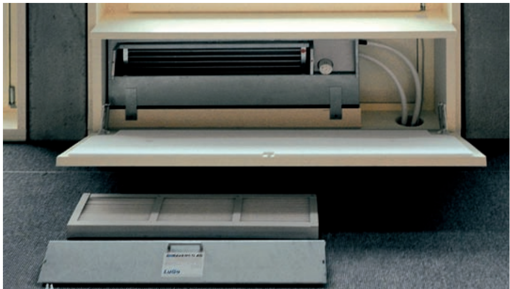
Abb. 03_04: Zuluft-Box im Bürogebäude Amstein und Walther in Zürich. Die einströmende Zuluft (Hygiene-Grundlüf- tung) kann im Winter über einen eigenen, an das Heiz- system angeschlossenen Lufterhitzer vorgewärmt werden. Die eigentliche Raumheizung erfolgt über Betonkernaktivierung. [Quelle: Amstein und Walther]
