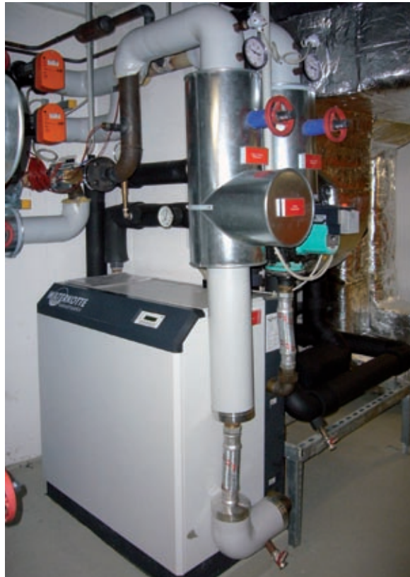
Abb. 06_02: Wärmepumpe in der Handwerkskammer-Akademie in Augsburg (Projektsteckbrief siehe Kapitel 9). Das Aggregat hat eine Wärmeleistung von 47 kW und nutzt das Grundwasser als Wärmequelle.
