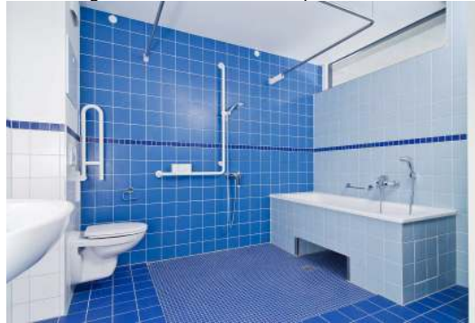
Behindertengerechtes Bad mit Duschplatz und Badewanne
