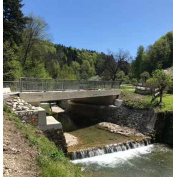
36 St 2102 Erneuerung der Brücke über Oberteisendorfer Ache bei Kumpfmühl Staatliches Bauamt Traunstein Gesamtkosten: 0,6 Mio. € Fertigstellung 2020
