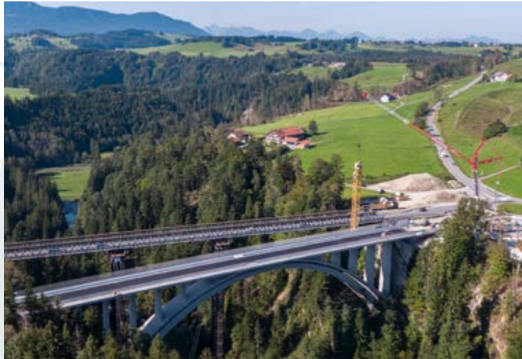
B 23, Erneuerung der Echelsbacher Brücke in der Nähe von Bad Bayersoien. Das linke Bild zeigt den Bauzustand im August 2019. Das Luftbild rechts wurde im September 2021 aufgenommen.
